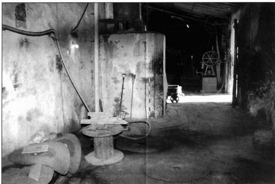
FOTO 13: Bomba hidráulica (12) y caldera (15) al fondo. Los capachos del suelo indican la trayectoria de la canalización subterránea (21) que une los depósitos de decantación.
