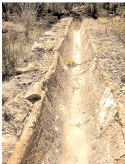
Canalización tradicional en teja árabe para el transporte de las aguas potables del manantial de La Carrasca.
