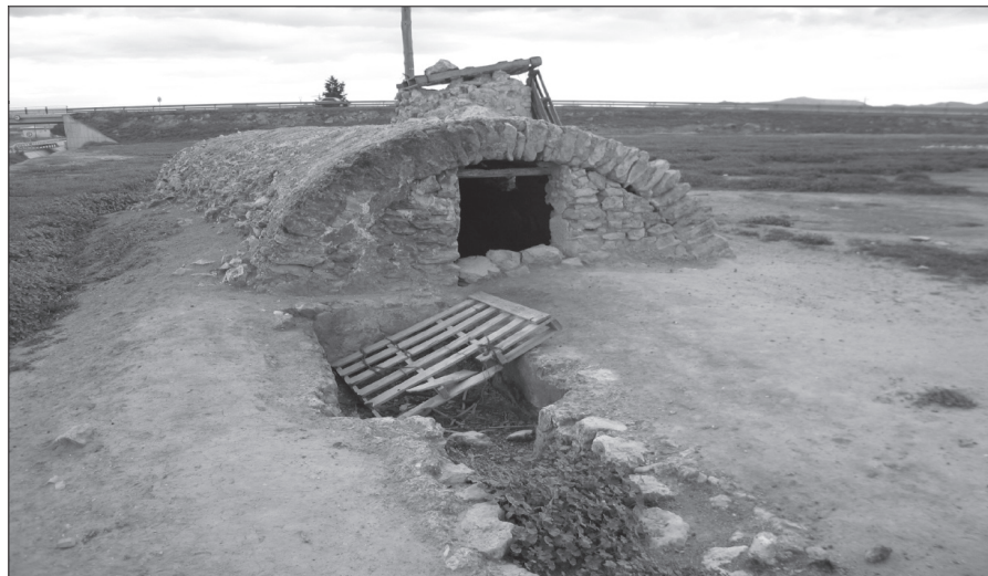
FIGURA 18. Canaleta, de fábrica en seco, en su acometida a la arqueta de decantación. Campo de Cartagena.
