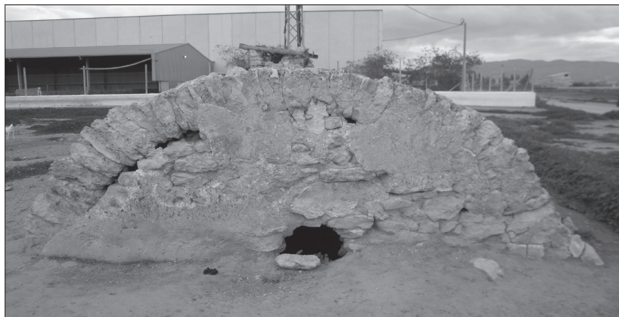
FIGURA 11. Bóveda ejecutada con lajas de piedra sin desbastar colocadas en posición radial. Campo de Cartagena.
