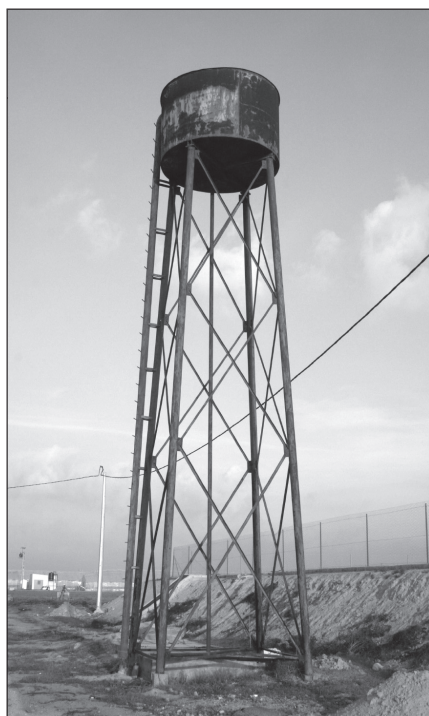
LÁMINA 3: Depósito de agua de la Comunidad de Regantes del Campo de Cartagena.
