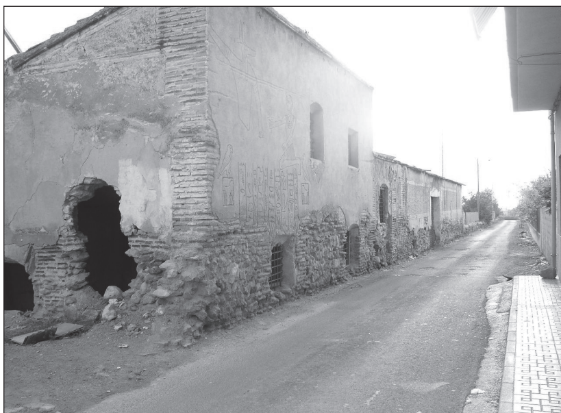
FOTO 6. Fachada exterior del ala oeste. En primer término un sector conservado de la antigua crujía; al fondo, la almazara de la posada.
