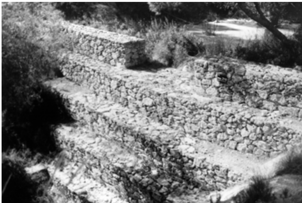
FIGURA 3. Dique de gabiones en el barranco Salar. Obsérvese que se encuentra totalmente aterrado de sedimentos.
