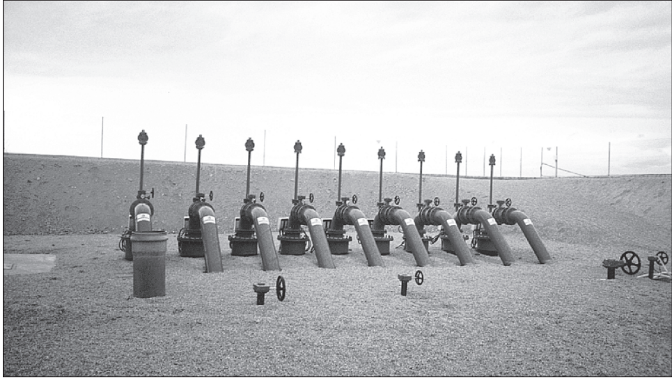
FOTOGRAFÍA N° 3: Estación de bombeo de la S.A.T. Llano Verde [K.C]
