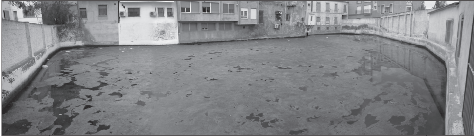
FIGURA 10 Balsa de la Sociedad de Aguas de Puerto Lumbreras de 1.185 m 3 .
