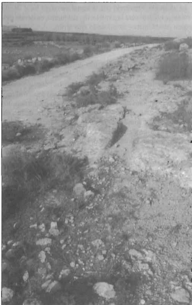
FIGURA 15. Carriladas de la Venta del Vidrio (Hellín).
