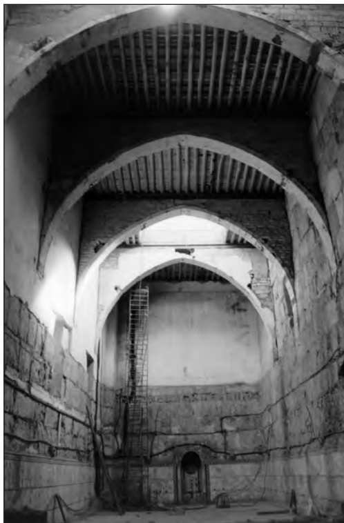
FIGURE 7. Hall à droite de la porte occidentale avec sa toiture islamique et le grattage de ses murs.
