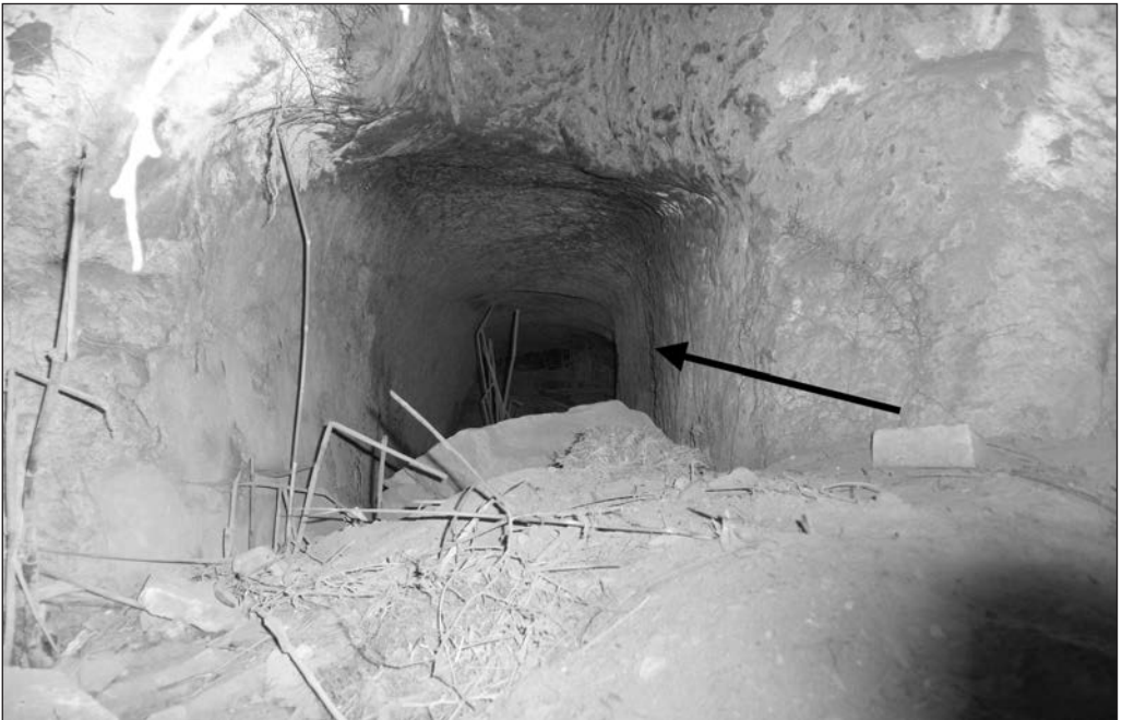
Lámina 3.1.V Debajo de la muela, entrada de agua
