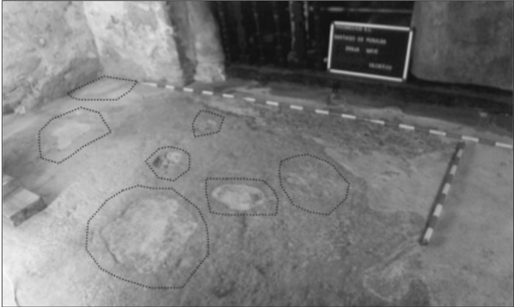
FOTO 10. Suelo de la nave. Con trazo discontinuo están contorneadas las lagunas, y señalada con las flechas una gran pérdida.
