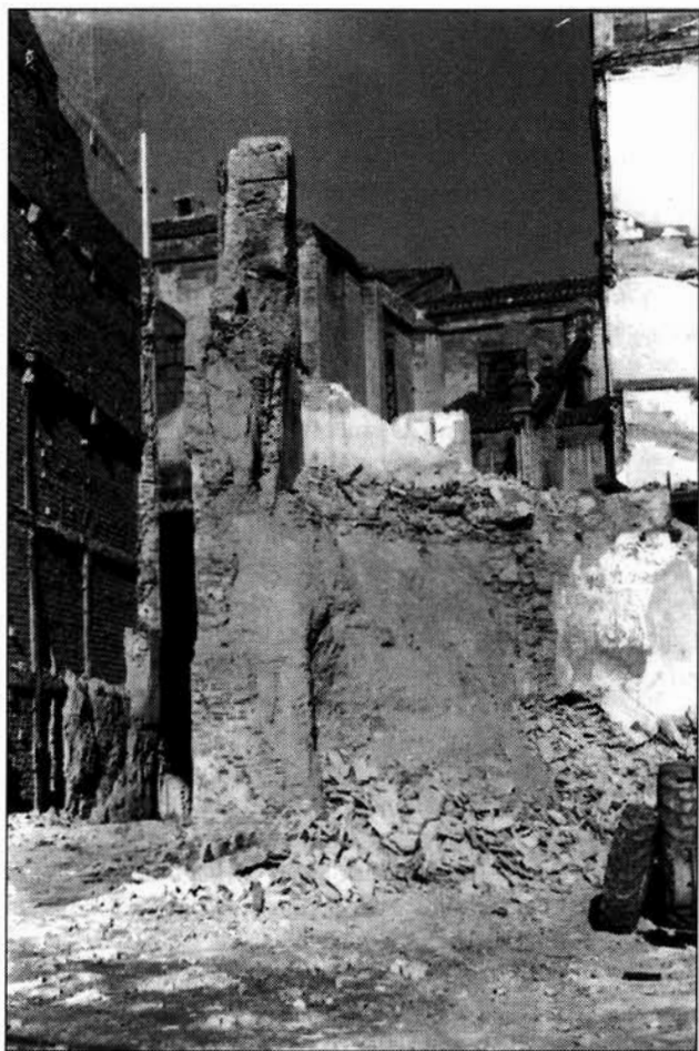
FIGURA 2. Torreón de la muralla del alcázar aparecido durante la demolición de la casa del obispo Trejo, entre las calles Apóstoles y Eulogio Soriano. Al fondo, la catedral.
